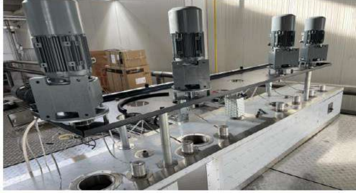
Şekil 2. İki pozisyonlu yağ tankı, pompa sehpaı, dört adet pompa tahrik motoru ve red¼kt¼r¼
